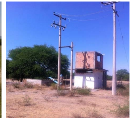
Robo de Transformador
